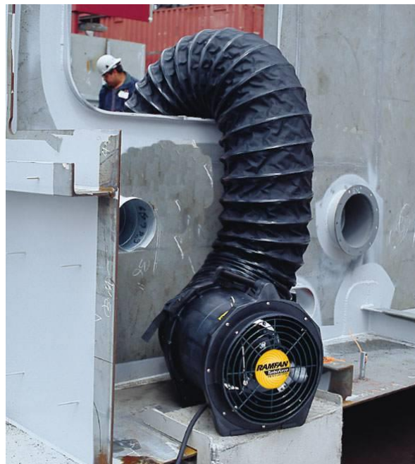
Mangote acoplado ao Ventilador
