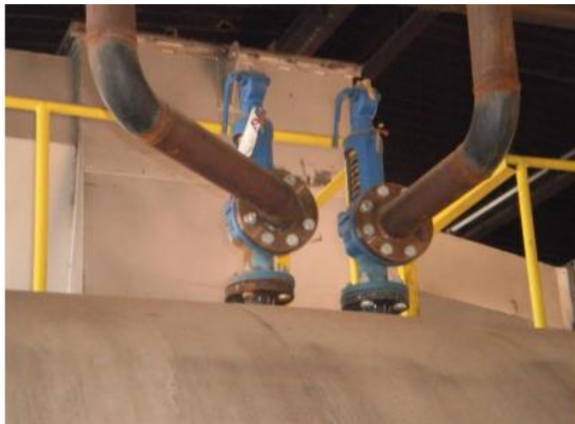
Exemplo de conjunto de válvulas de segurança e alívio montadas em uma caldeira
